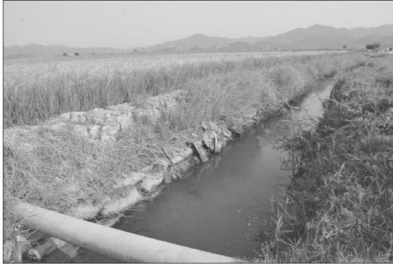
Tuyến kênh N2-10 tại xã Buôn Triết, huyện Lắk không được thi công bằng tám lát bê tông nhưng bị nghiệm thu “khổng” để thanh toán trên “giấy”.
