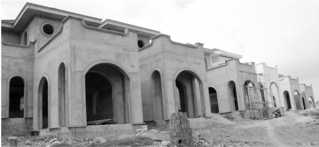
22 công trình liên kế xây dựng không phép tại thôn 10A, xã Lộc Thành.
