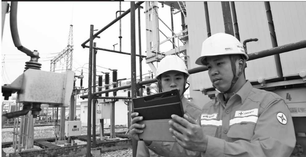
Kiểm tra vận hành tại TBA 500 kV Tây Hà Nội.
