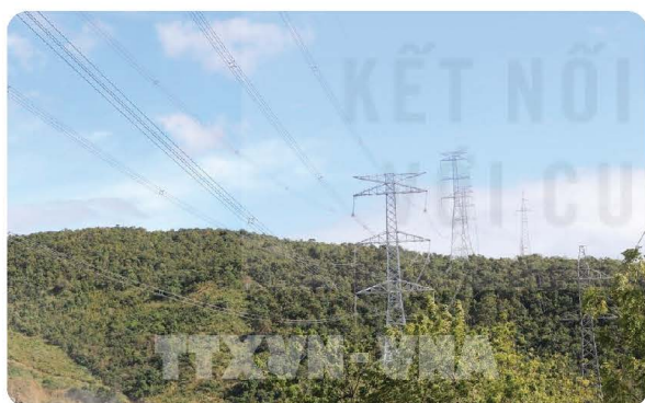
Hình 21.6. Một đoạn đường dây 500 KV Bắc – Nam
