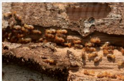
Mối phá hoại công trình xây dựng
