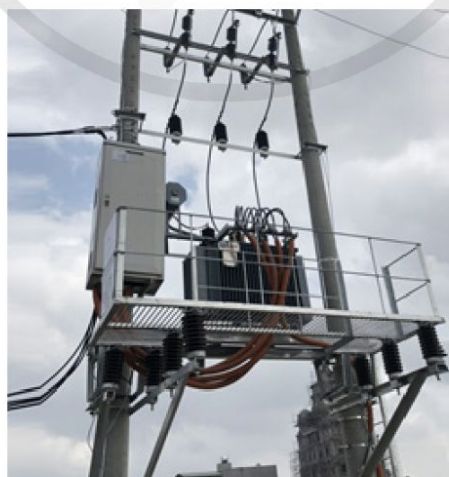
Hình 6.2. Trạm biến áp treo
