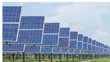
d) Nhà máy điện mặt trời
